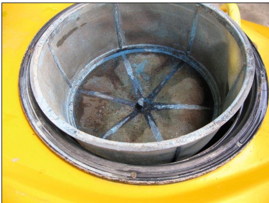
Filtro a cestello del serbatoio principale in cattivo stato di manutenzione.
