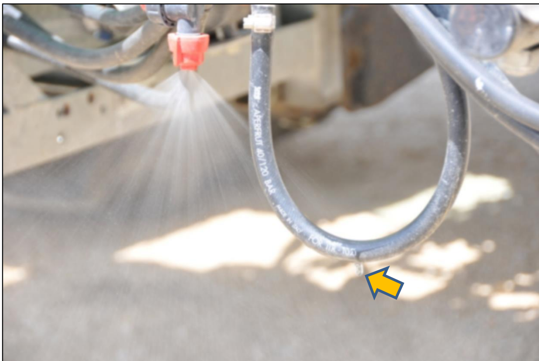
Tubazione investita dal getto del liquido e conseguente anomalo gocciolamento.
