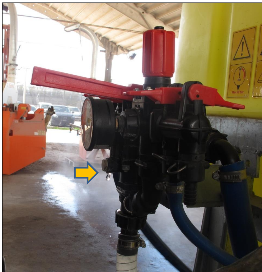
Evidente gocciolamento dal gruppo comando.
